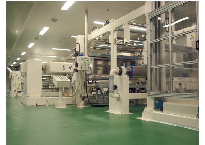
写真2 ●岡山工場に導入した新規設備
